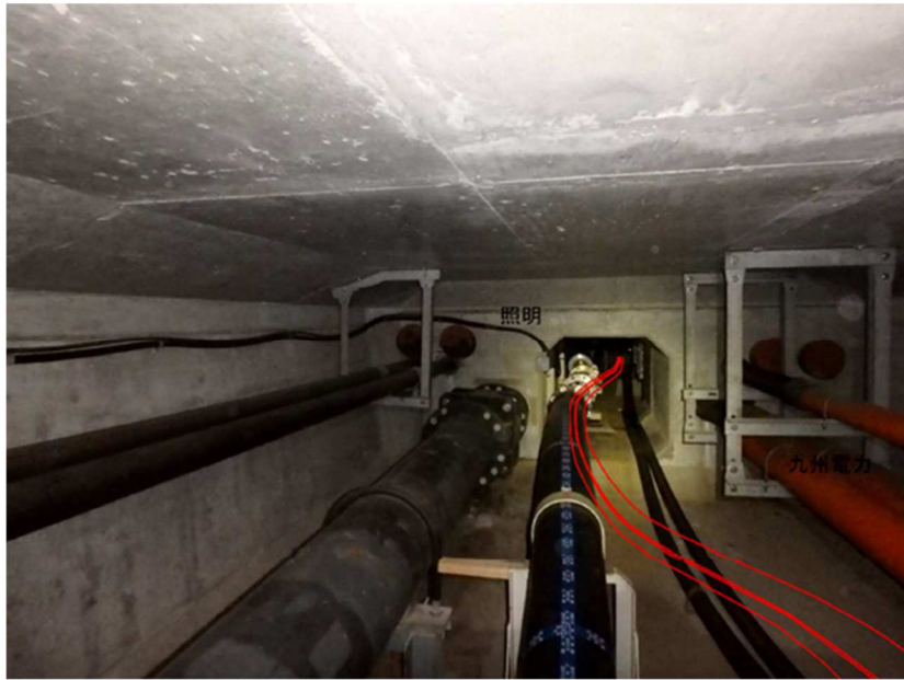
图 2.2.5-6 (1) 送電線橋梁内部共架例
