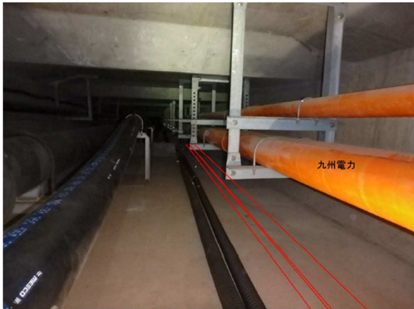
图 2.2.5-6 (2) 送電線橋梁内部共架例
