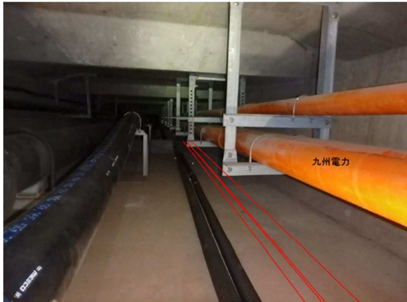
图 2.2.5-6 (2) 送電線橋梁内部共架例
