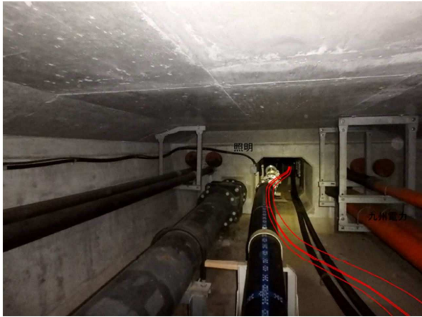
图 2.2.5-6 (1) 送電線橋梁内部共架例
